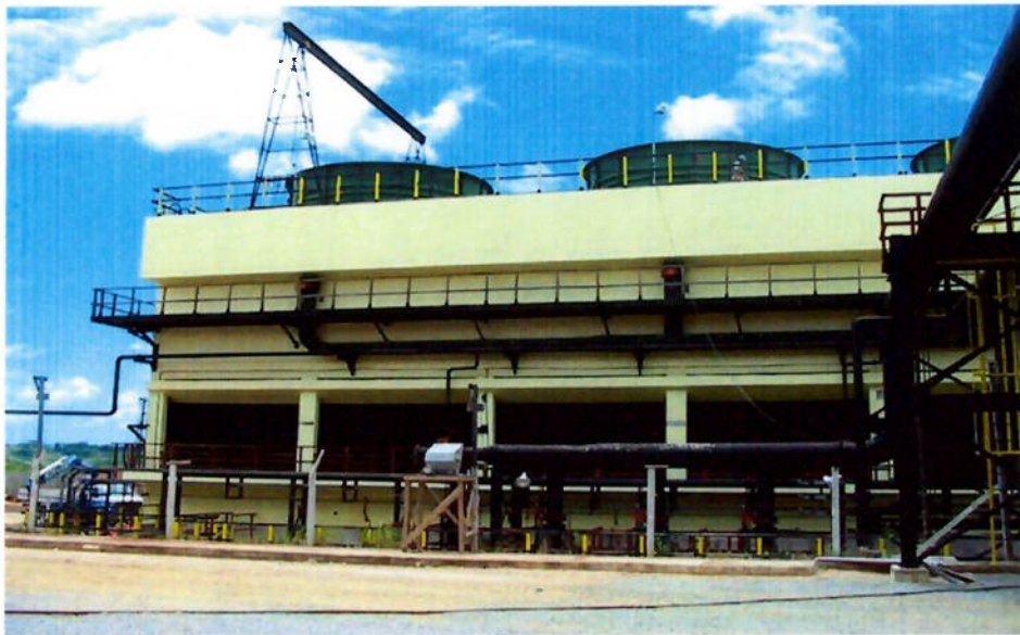
Figura 13 - Planta de refrigeração – Torre de arrefecimento de ar
