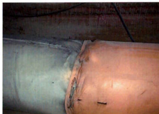
Figura 30 – Acoplamento errado entre dutos Fonte: Arquivos UOTV
