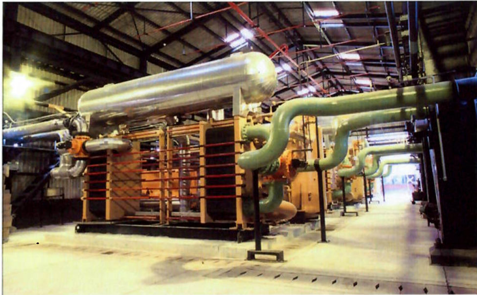
Figura 15 - Planta de refrigeração – Compressores tipo parafuso – \text{NH}_3 Fonte – Arquivos Vale
