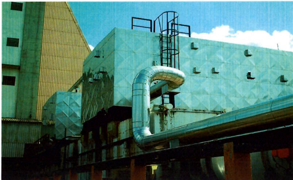
Figura 16 - Tanque de abastecimento água gelada para subsolo: admissão e retorno Fonte – Arquivos Vale
