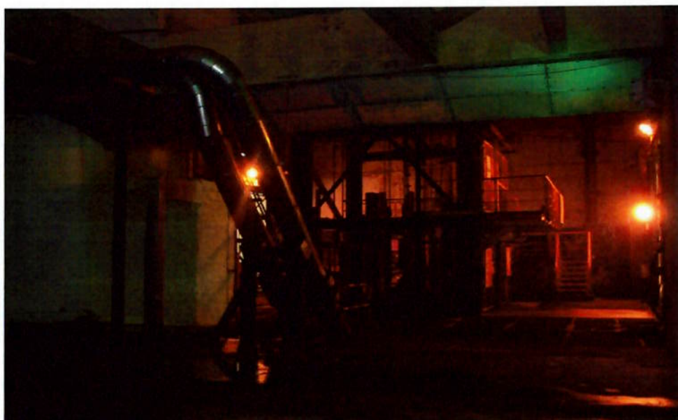
Figura 17 - Tubulação de água gelada para subsolo – Poço 2
