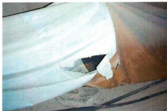
Figura 28 – Dutos rasgados no acoplamento Fonte: Arquivos UOTV
