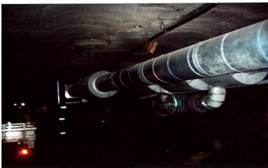
Figura 18 - Tubulação de água gelada para área norte
