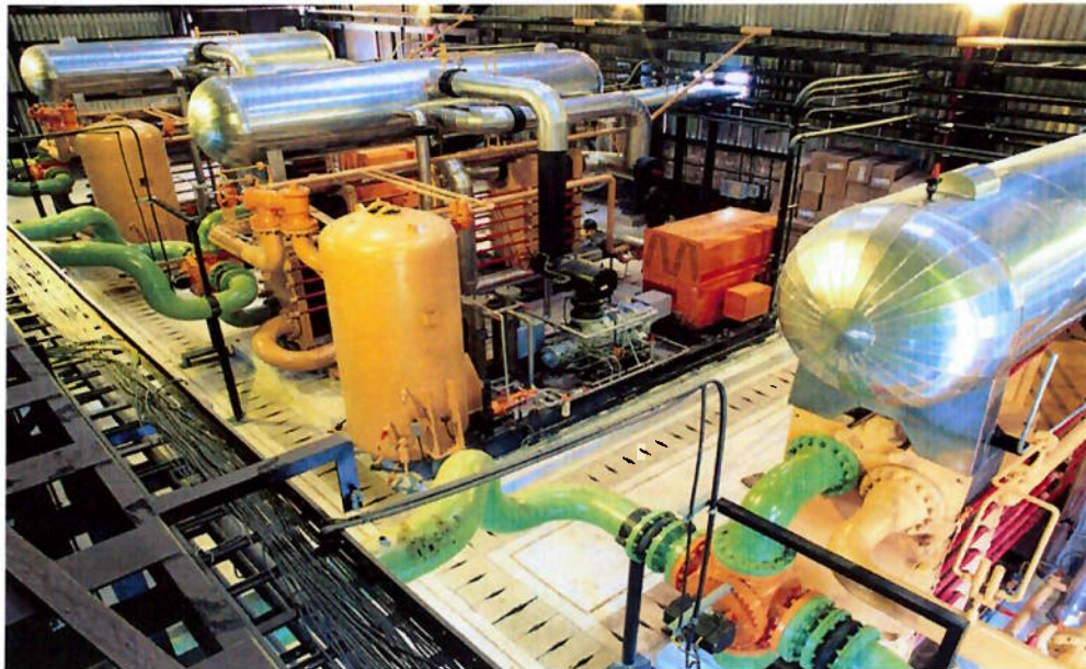
Figura 14 - Planta de refrigeração – Torre de arrefecimento de ar
