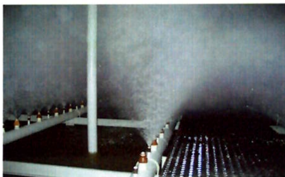
Figura 21 - Pulverização de água gelada – Câmara de resfriamento de ar
