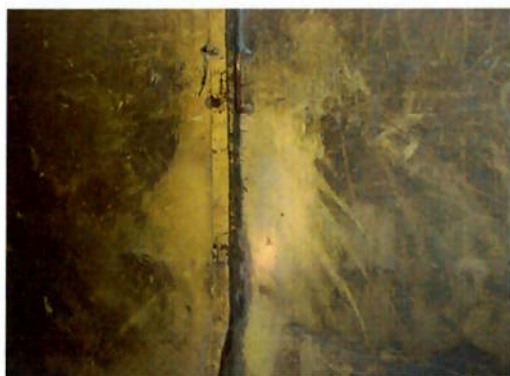
Figura 27 – Porta de ventilação danificada Fonte: Arquivos UOTV
