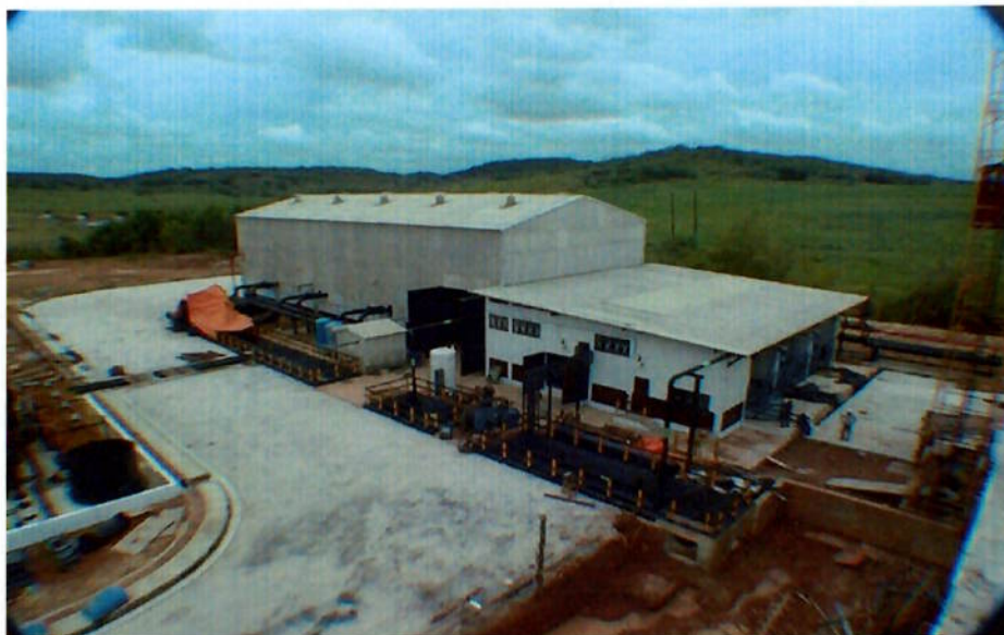
Figura 11 – Planta de refrigeração (Casa de máquinas dos compressores) Fonte: Arquivos OUTV(2006)
